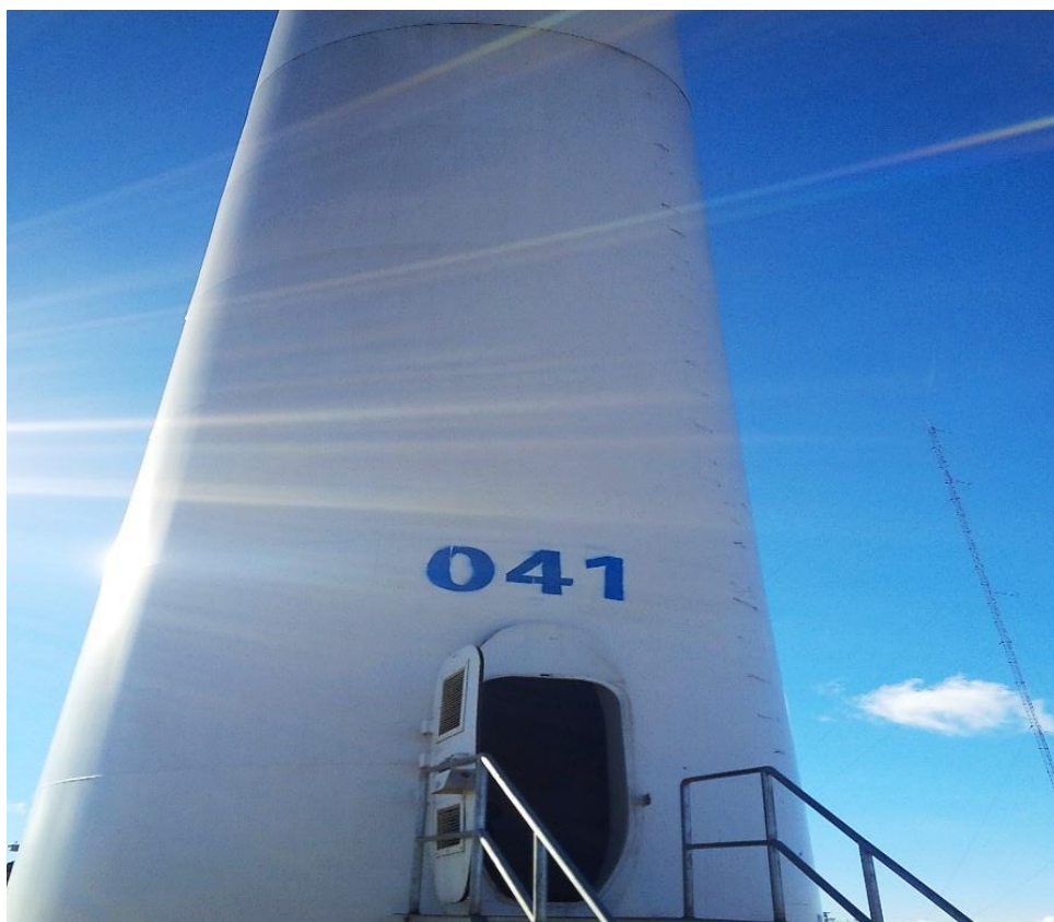
Imagem 1: Gerador eólico nº 41 em Luxi
